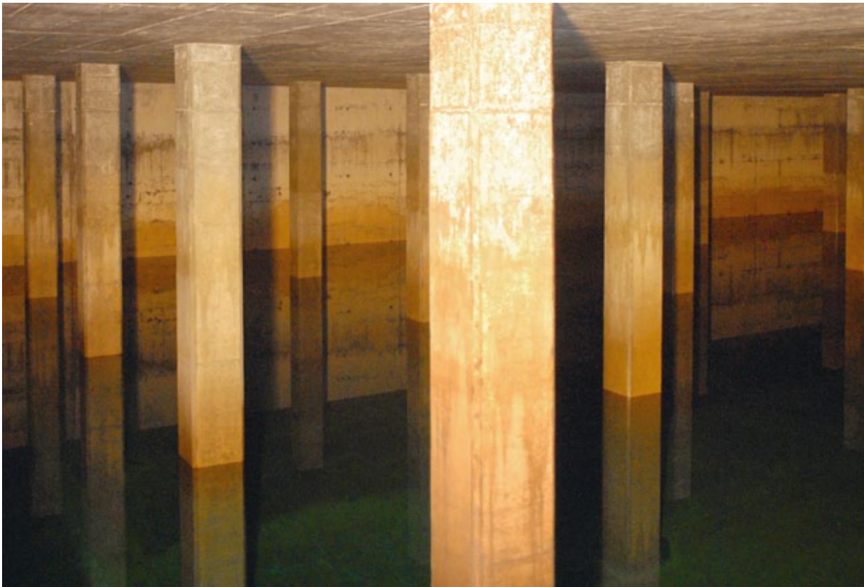
Im Reservoir Lyren in Zürich Altstetten wird das Trinkwasser gesammelt.
